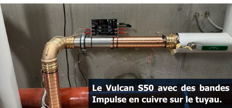
Le système de tuyauterie d'eau après l'installation du Vulcan S50.
