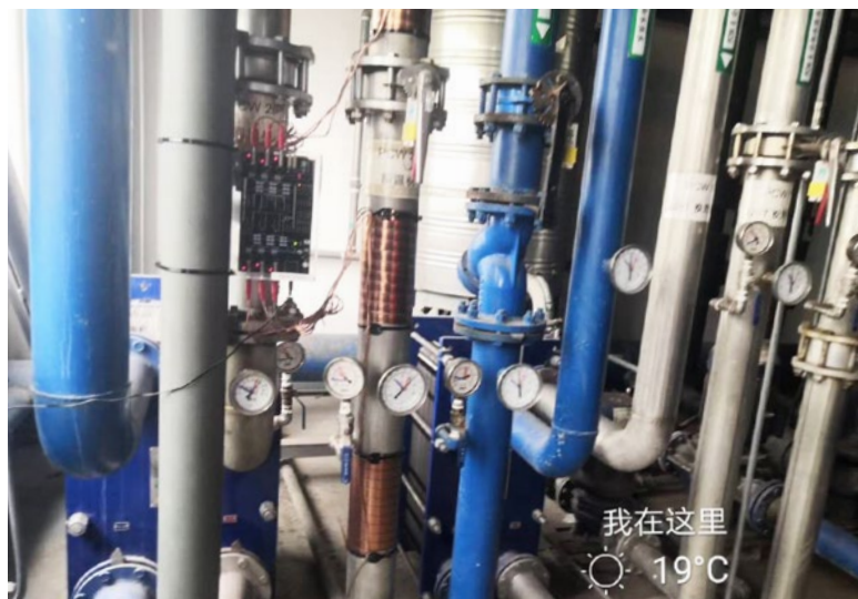
Vulcan S100 a été installé après le réchauffeur.
