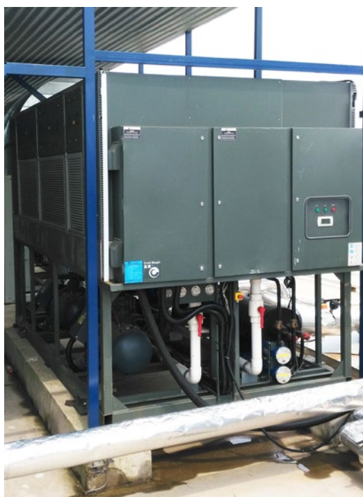
Dispositif principal de climatisation
