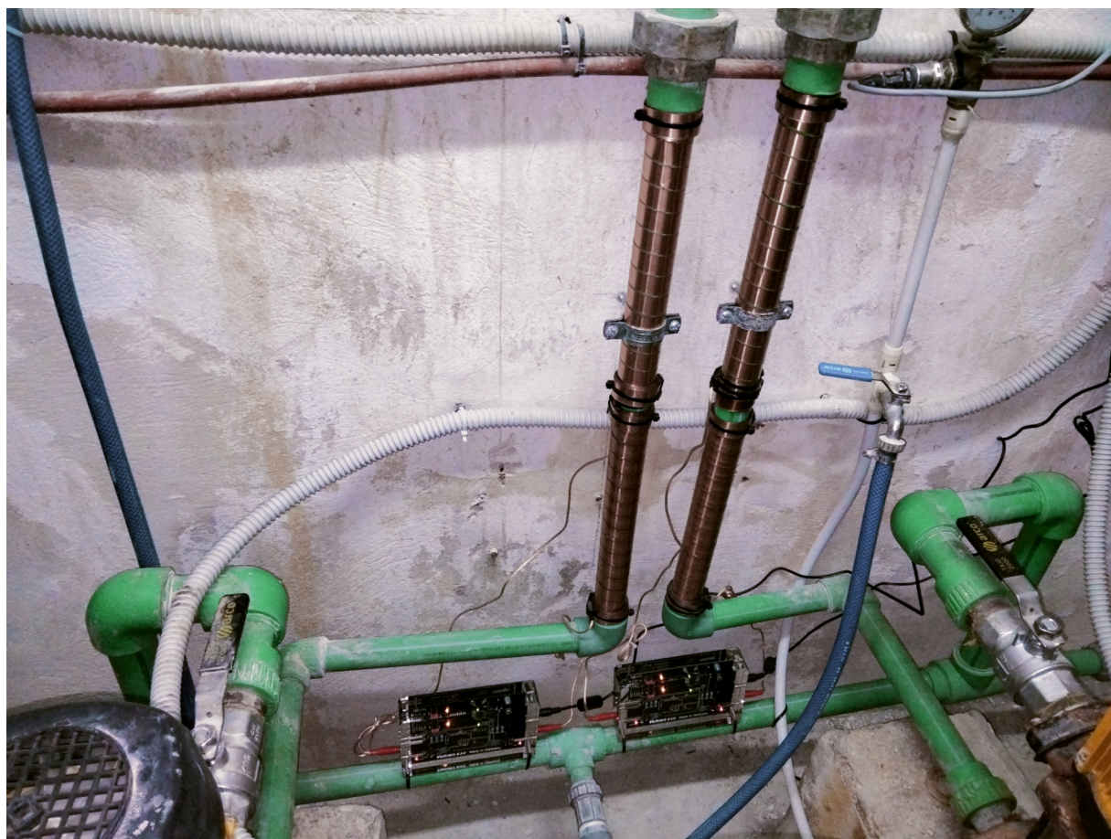
2 x Vulcan S10 Conduite principale d'eau froide avec Ø 41 mm
