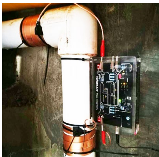
Vulcan S10 a été installé sur le tuyau principal d'évacuation de l'eau.
