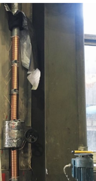
Vulcan S25 a été installé sur l'arrivée principale des tours de refroidissement de l'usine de moulage.
