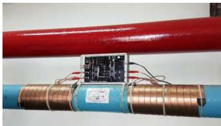
Le dispositif anti-calcaire électronique Vulcan S25 installé
