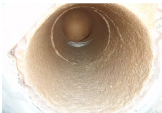
Conduit de circulation
