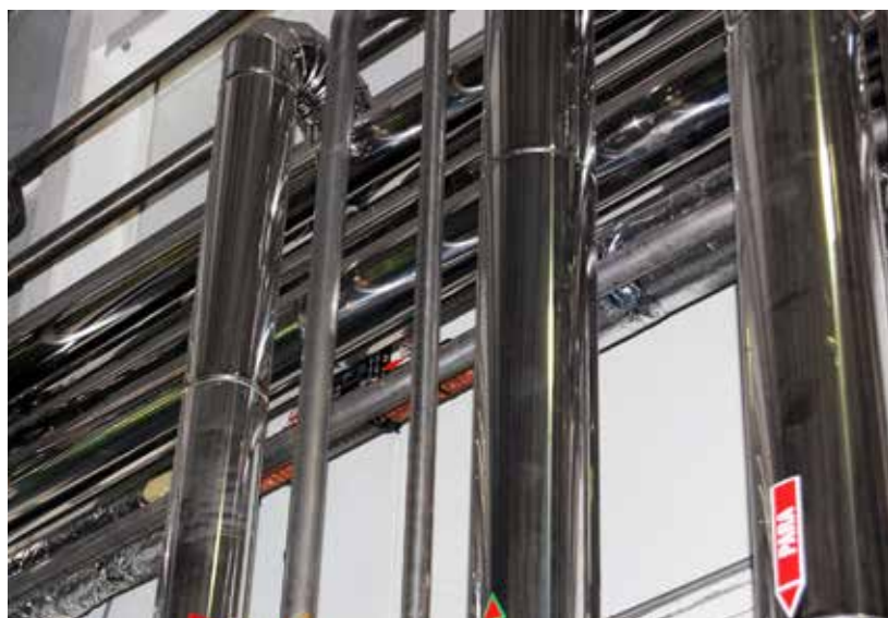
2 x Vulcan S25 ont été installés pour traiter l'eau pour toute la brasserie.
