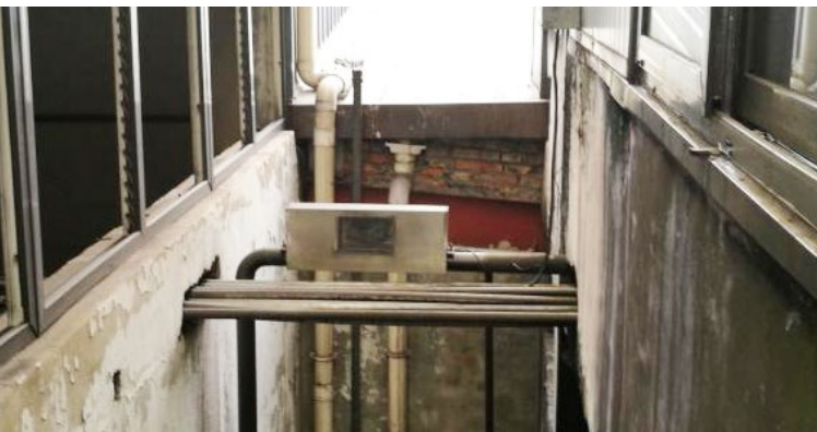
Installation de Vulcan S25 à l'extérieur.
