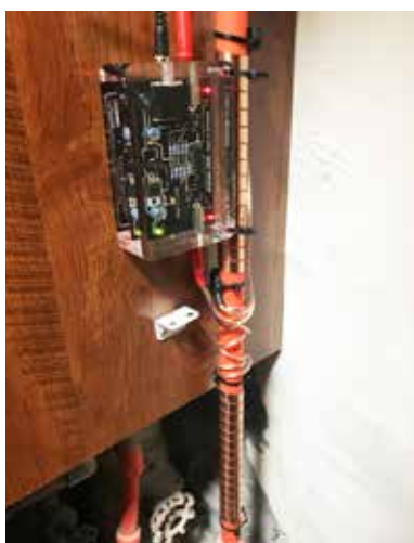
Vulcan 3000 a été installé sur l'entrée principale de l'habitation.
