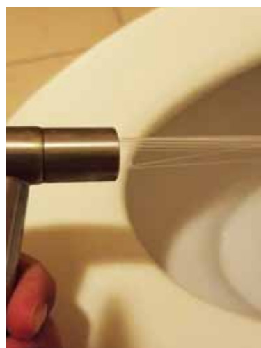
Avant l'installation : le canon à eau était obstrué au 2/3 par le calcaire.
