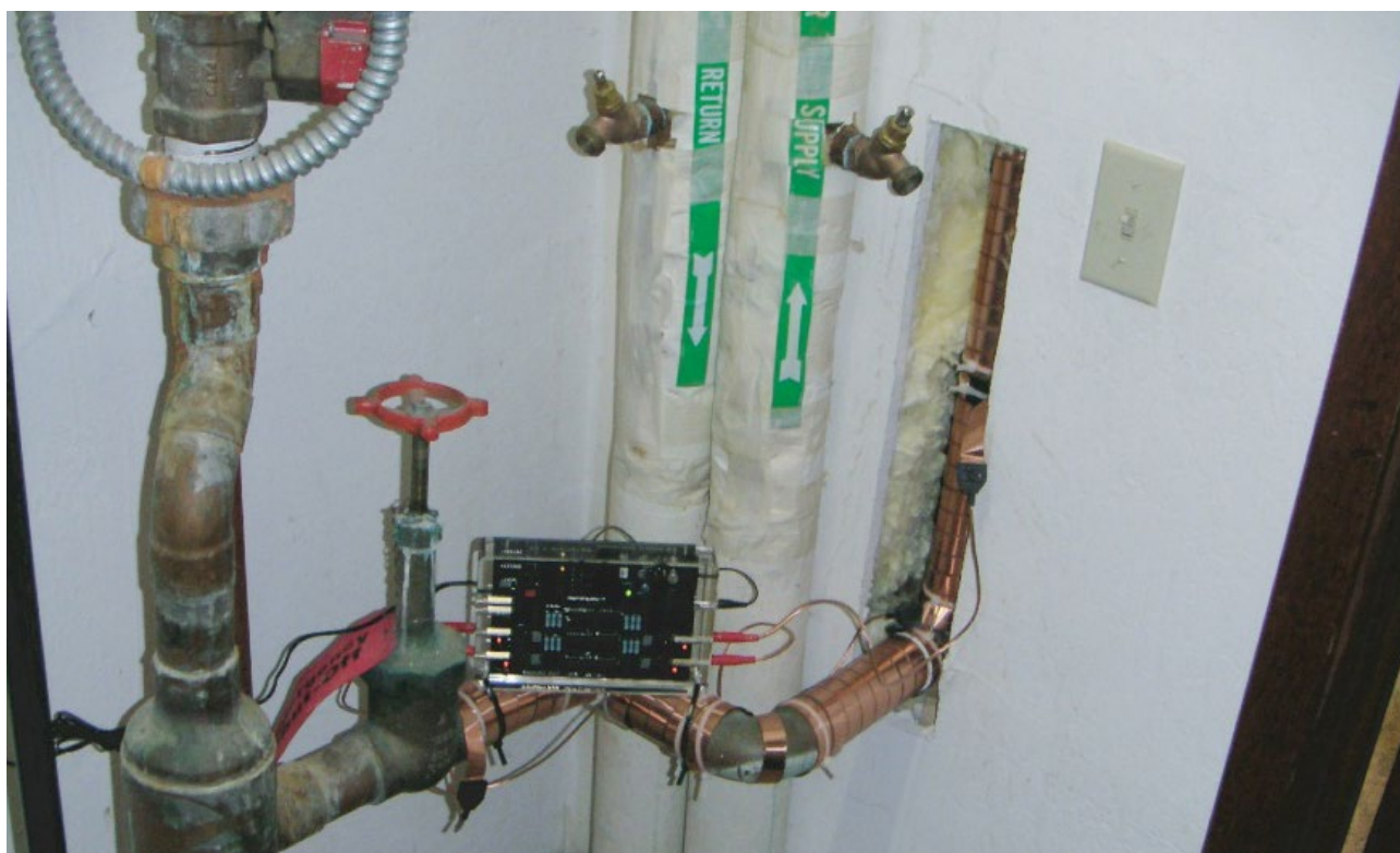
Vulcan S25 installé dans le bâtiment E au Centre de santé
