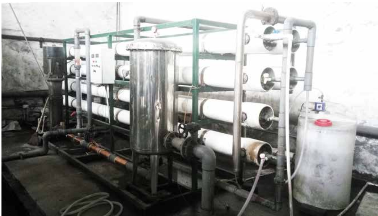
Vulcan S100 a été installé à l'entrée de la membrane de l'osmoseur.
