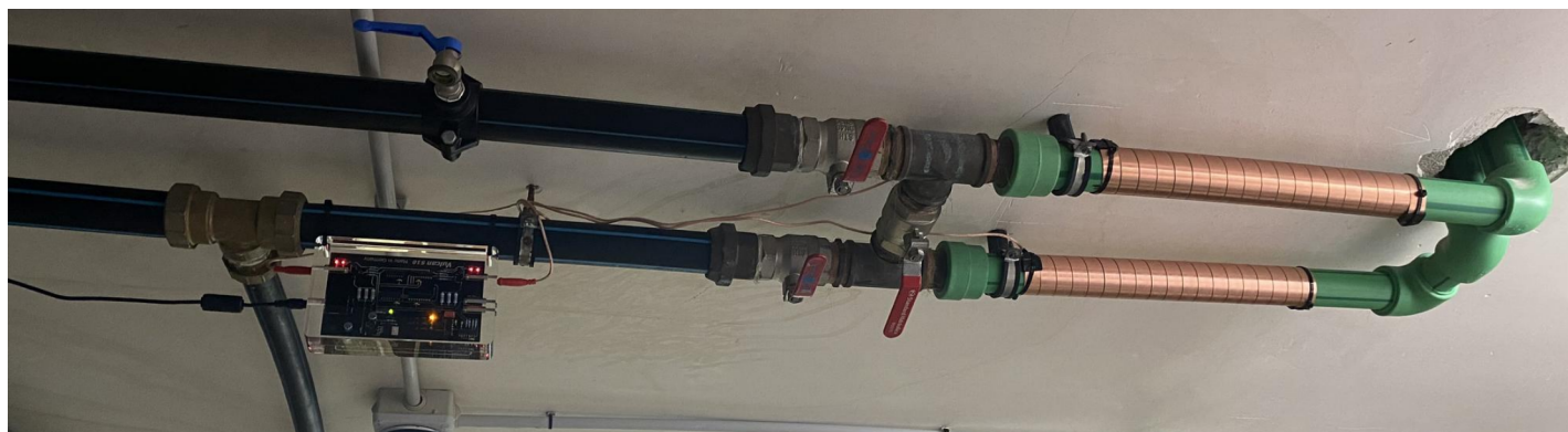
Vulcan S10 la conduite de l'eau d'irrigation de Ø 63 mm
