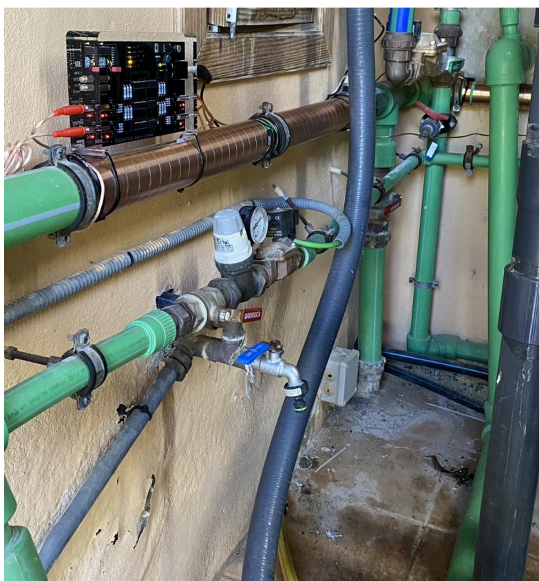
Vulcan S50 sur le tuyau d'eau froide de Ø 63 mm
